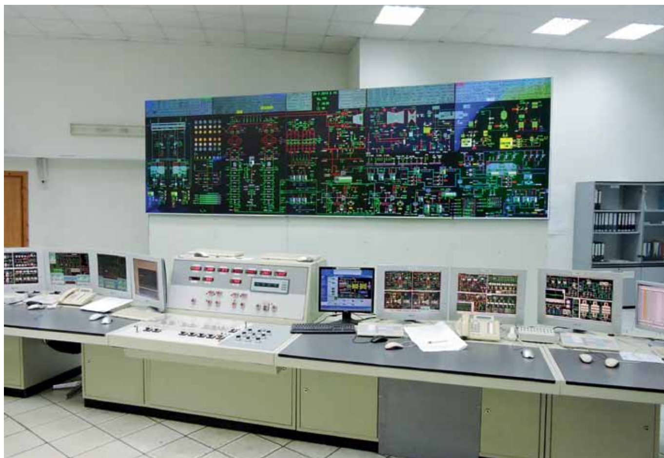
Рис. 1. Пульт управления энергоблоком Сургутской ГРЭС-2
